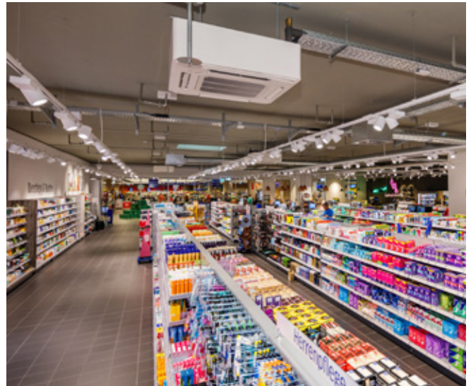
Die insgesamt vierzehn 4-Wege-Deckenkassetten gewährleisten eine zugfreie Luftumwälzung im Bereich der Verkaufsfläche.
